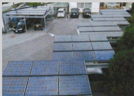
太陽光発電設備(9.2kW)
